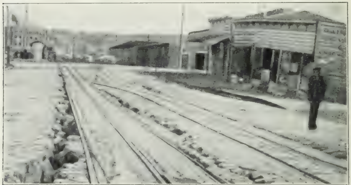
Fig. 11. Risse in Valentia Street, San Francisco, nach dem Erdbeben 1906.
